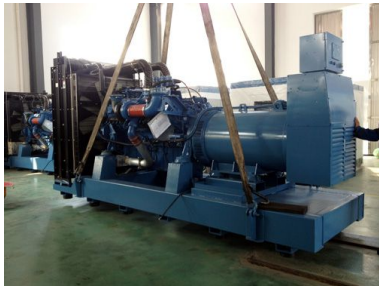
东南亚客户 2台600KW MTU发电机组
