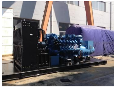
西藏机场 1200KW MTU静音发电机
