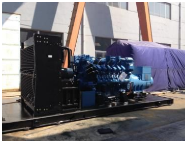
西藏机场 1200KW MTU静音发电机
