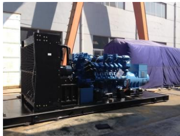
西藏机场 1200KW MTU静音发电机
