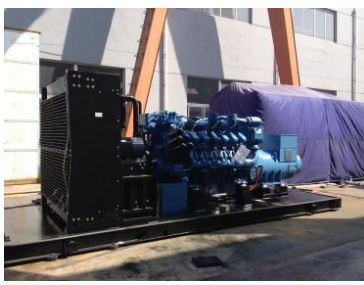
西藏机场 1200KW MTU静音发电机
